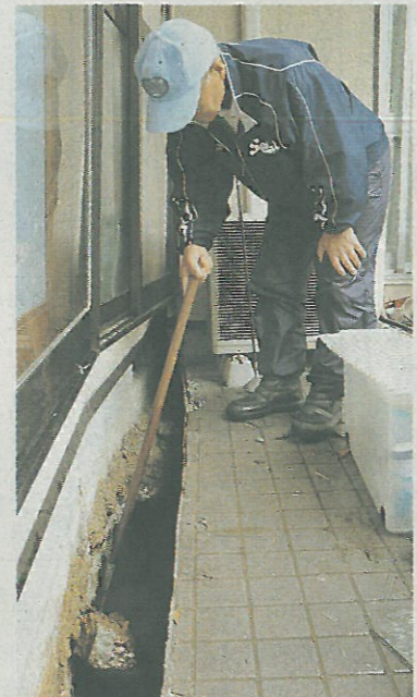
地滑りで庭が陥没した住宅。家屋も傾き、不自由な生活を強いられている一仙台市青葉区折立5丁目
